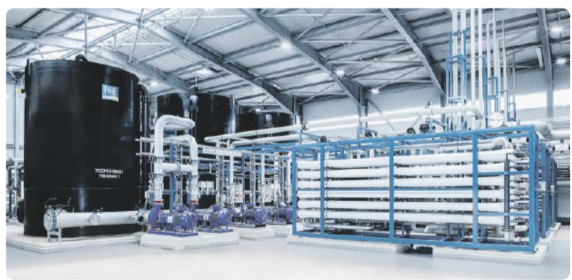
Die neue Deionatanlage symbolisiert die Investitionsbereitschaft in Leuna.
