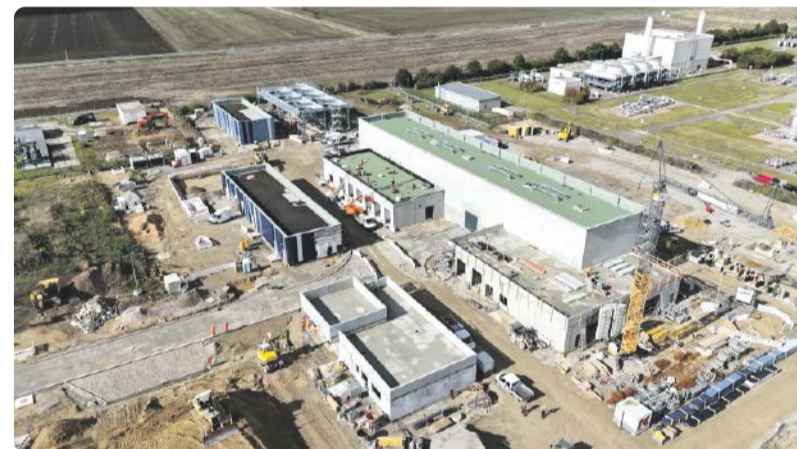
Im Energiepark Bad Lauchstädt werden alle Aspekte der intelligenten und wirtschaftlich optimalen Integration des Energieträgers grüner Wasserstoff abgedeckt.
