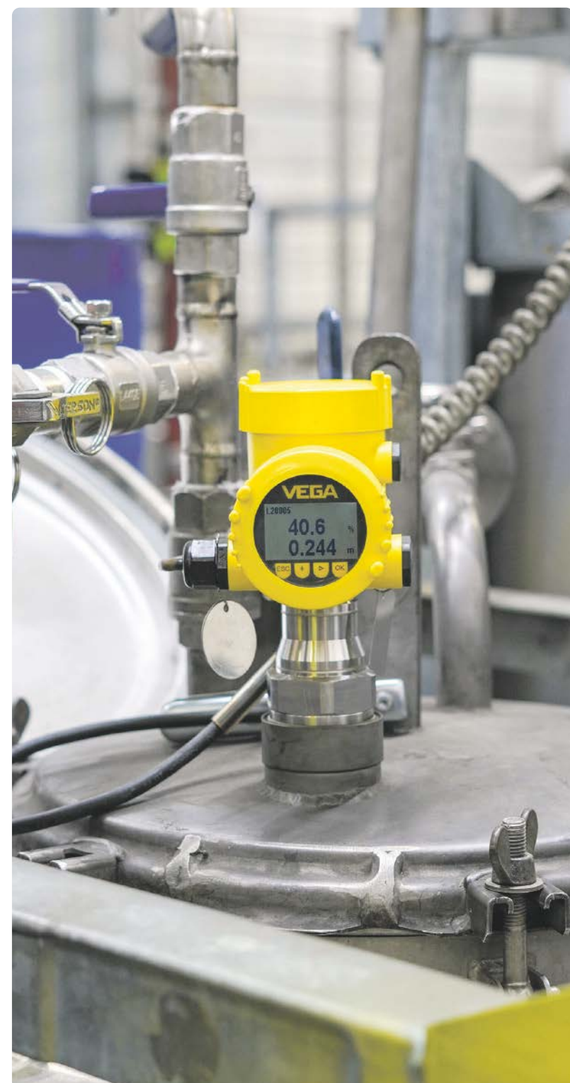
Hochgenau überwachen Radarsensoren Vegapuls 6X die Füllstände an mobilen Lagertanks bei Röhm, in denen Reststoffe aus der MMA-Produktion gesammelt werden. Selbst kleinste Prozessabweichungen müssen hier zuverlässig vermieden werden, damit die Produktqualität stimmt.
