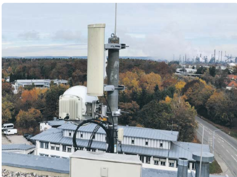
Um für Chemiewerke sowie Zuliefer- und Logistikunternehmen im bayerischen Chiemdreeck eine leistungsstarke und verlässliche Internetanbindung herstellen zu können, wurde eine zuverlässige Point-to-Point (PTP)-Richtfunklösung installiert.
