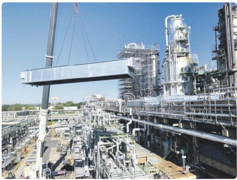
Die neue Grundöldestillation am Standort Wesseling wird mit Vakuumgasöl vom Standort Köln-Godorf versorgt. Dort wurde bereits ein neuer Luftkühler installiert.
