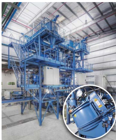
Evatherm-Anlage mit Vakuum-Verdampfungskühlung zum Einsatz für Schwefelsäure-Metalloxid-Reaktionen
