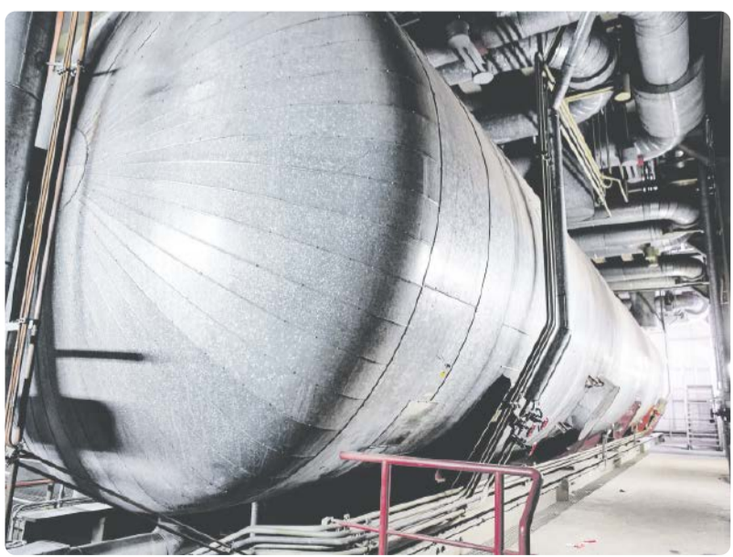
In der chemischen Industrie dienen Kessel als zentrales Element der Energieversorgung; sie liefern die notwendige Wärme für chemische Reaktionen, Trennprozesse und viele weitere Anwendungen. Der Wirkungsgrad eines Kessels ist von großer Bedeutung, da er die Effizienz der Energieumsetzung bestimmt.
