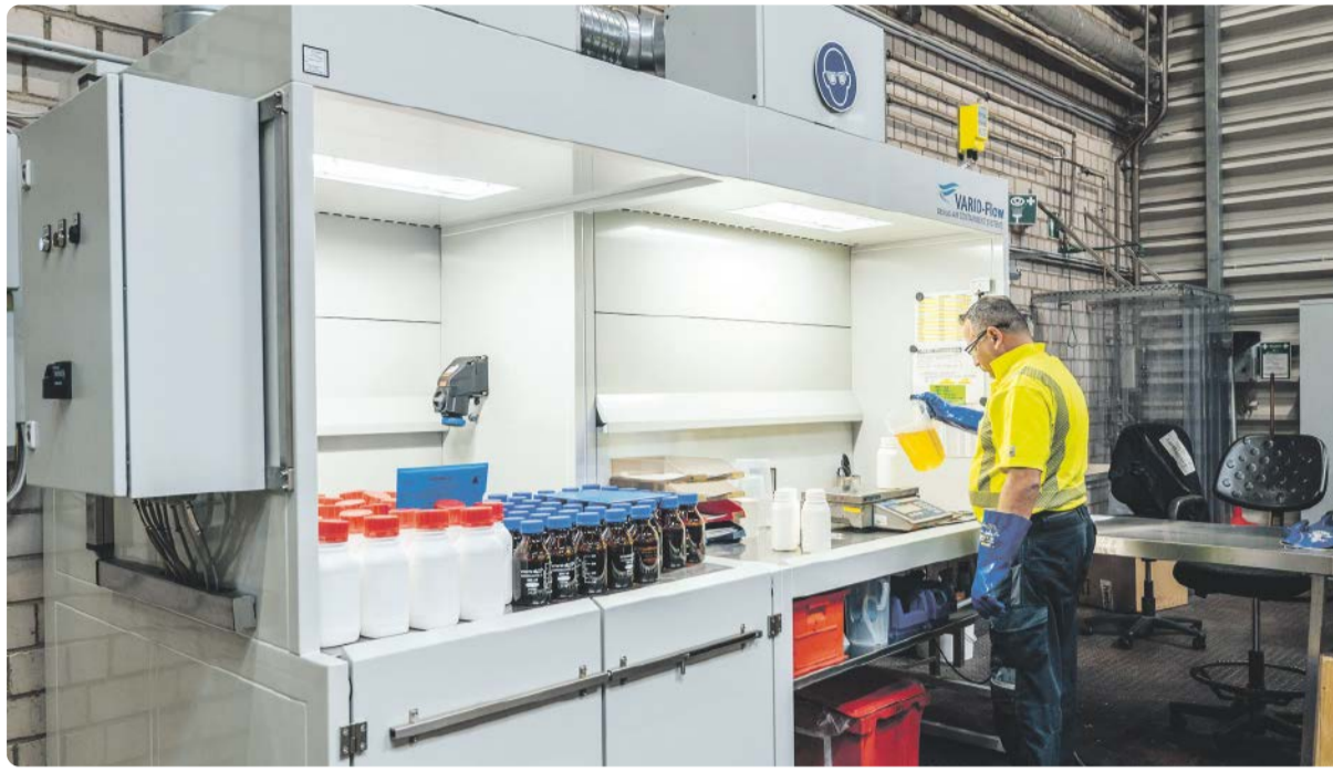
Die neue Abfüllkabine bei Infraserv Logistics bietet ideale Voraussetzungen zur Abfüllung von Produkten der Lagerklasse 3.
