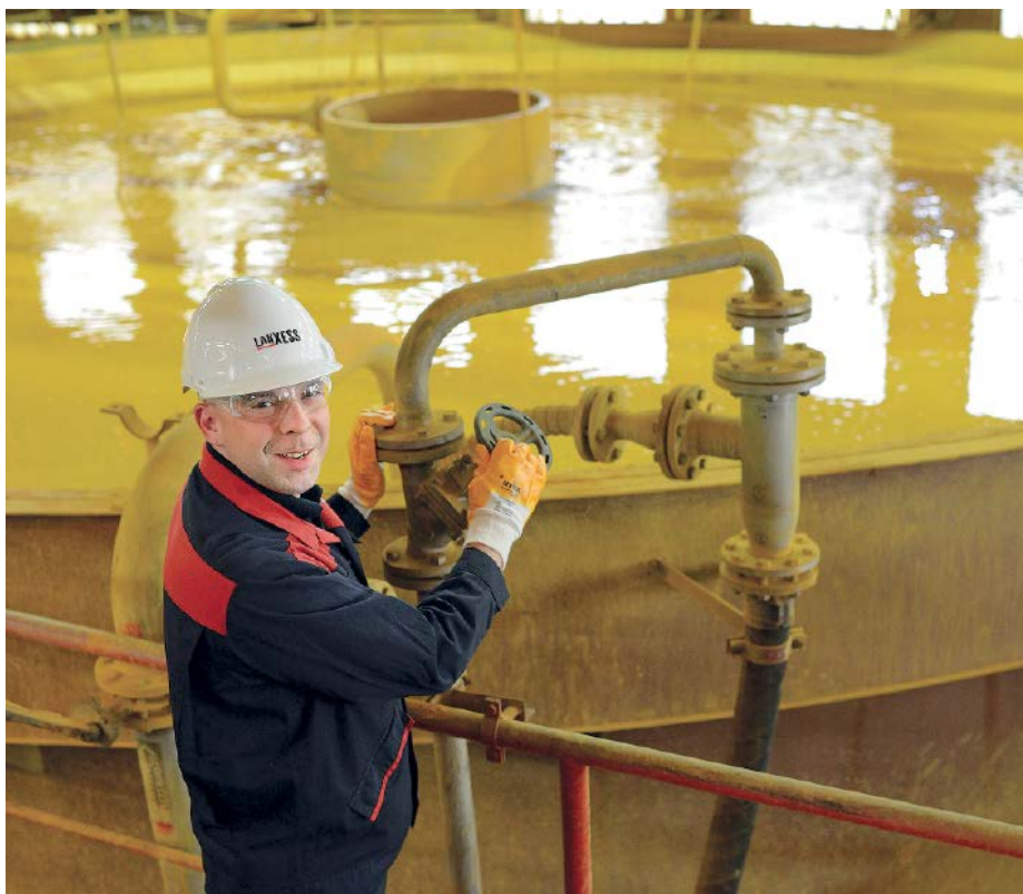
Produktionsanlage von IPG in Krefeld-Uerdingen zur Herstellung von Eisenoxiden.
