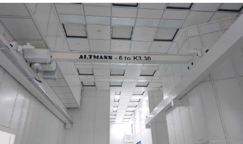
◀ Abb. 3: Reinraum Einträger-Laufkran mit 6 t Tragkraft und einer Spannweite von 6,9 m
