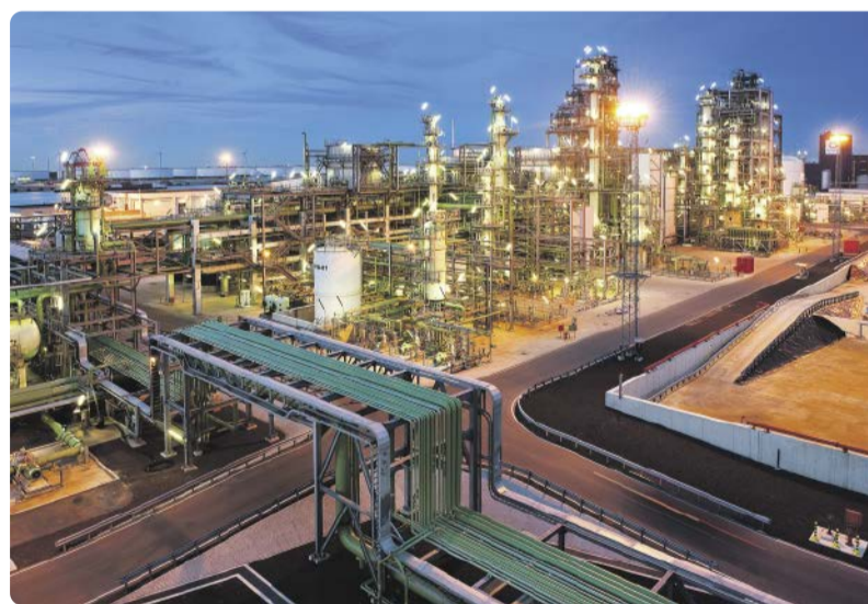
Neste-Raffinerie in Rotterdam: Insgesamt verfügt Neste über Raffinerien für den Einsatz erneuerbarer Rohstoffe mit einer Gesamtkapazität von etwa 3,3 Mio. t/a.
