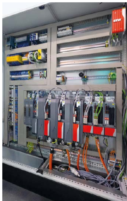
Abb. 5: Das kompakte Mehrachssystem Movidrive modular besteht aus Versorgungsmodulen, Rückspeisemodulen sowie Einachs- und Doppelachsmodulen. In diesem Schaltschrank ist energetisch zwischen der Einspeiseeinheit und den Antriebsreglern die Speichereinheit Movi-DPS für die Zwischenpufferung freierwerdender Energie platziert.
