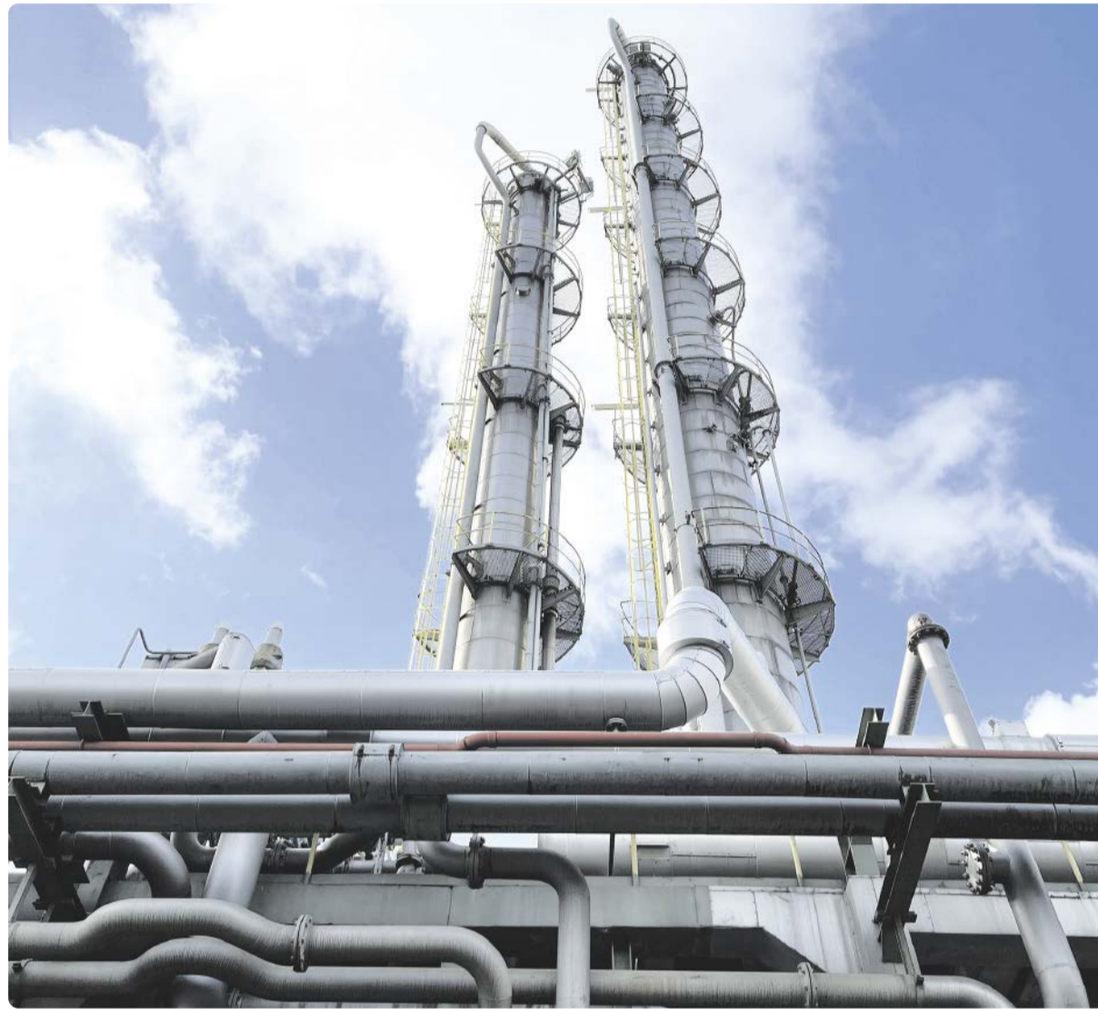
Mittels eines Smart-Safety-Tests an sicherheitsrelevanten Absperrklappen konnte Evonik in Marl die Verfügbarkeit einer Propen-Destillation erhöhen und die Zyklen zwischen Anlagenstillständen von einem auf drei Jahre verlängern.
