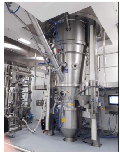
Abb. 3: Der Prüfstand steht außerhalb des Reinraums. Er wird über das Panel im Reinraum bedient.
