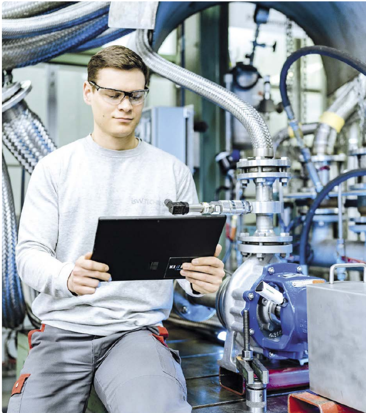
Die ISW-Technik verbaut kabellose „Optime“-Sensoren von Schaeffler für die intelligente Überwachung von Anlagen.
