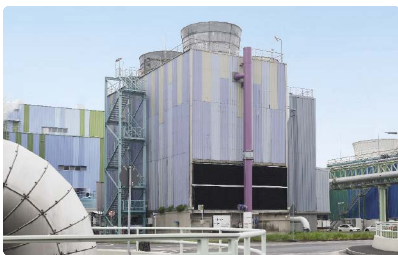
Mithilfe eines digitalen Zwillings konnte das Rückkühlwerk energieoptimiert werden.
