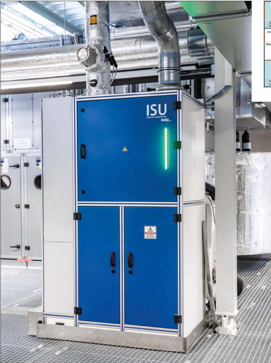
Abb. 15: H 2 O 2 Großanlage
