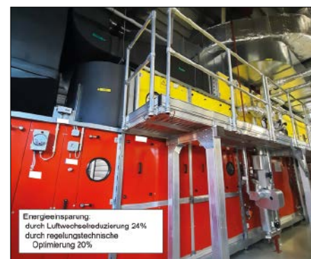
Abb. 5: Beispiel für die Energieeffizienzoptimierung einer Bestandsanlage in der Arzneimittelherstellung © STZ EURO
