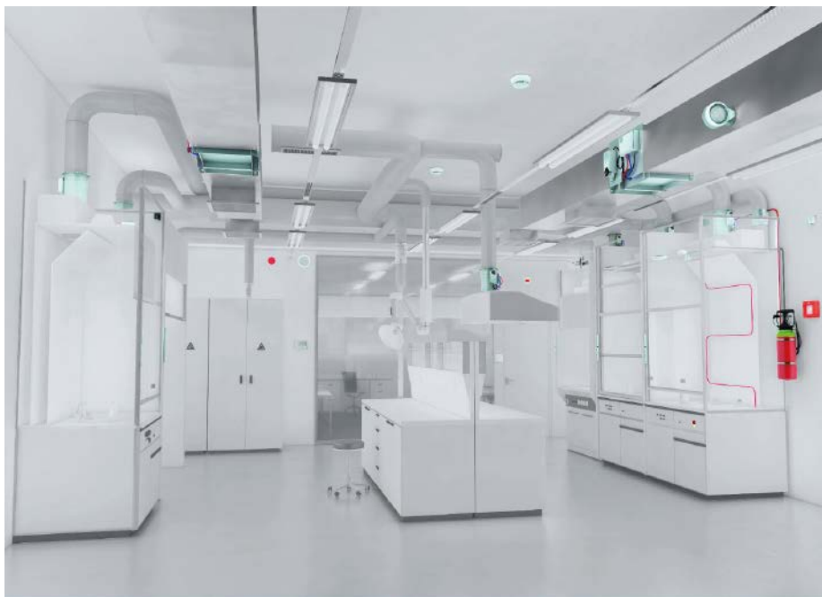
Abb. 3: Für die gebäudetechnische Ausstattung von Laboren und Reinräumen lassen sich sieben Kernbereiche identifizieren.
