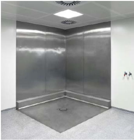
▲ Abb. 4: Vollverschweißt und ohne Silikonfugen: Der Reinraum-Waschplatz ist komplett wartungsfrei. © Glatt
