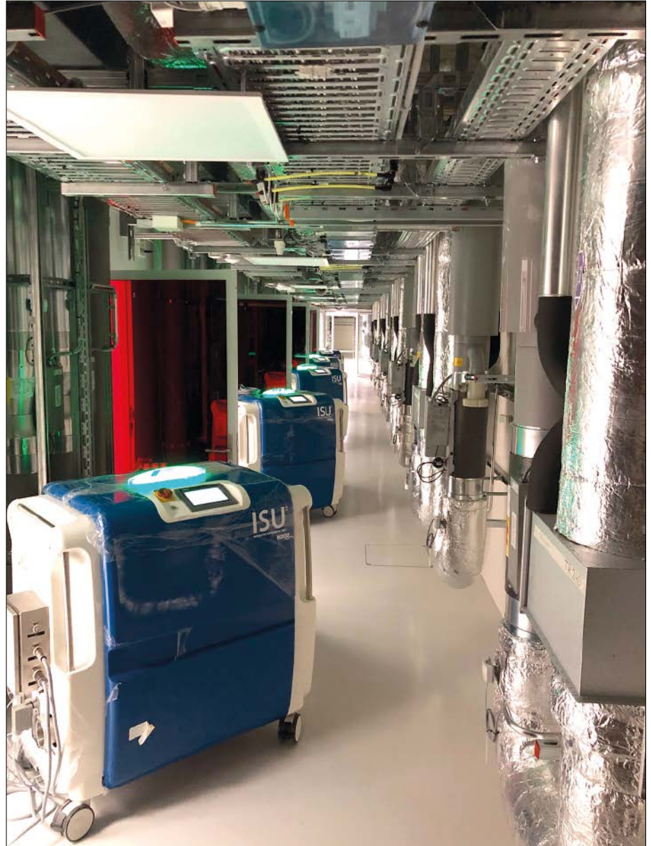
Abb. 14: H 2 O 2 Generatoren im Verbund
