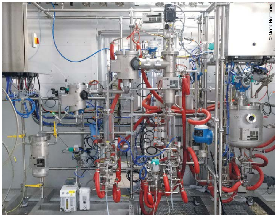
Beispiel eines standardisierten Anlagenmoduls (PEA) zur Rektifikation (Gegenstromdestillation) bei Merck in Darmstadt.
