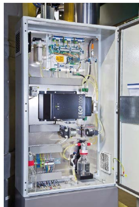
Die Flowevo-Sensoren werden in der von Burkhardt entwickelten und gebauten Analyseeinheit eingesetzt, die kompakt konstruiert und einfach austauschbar ist.
