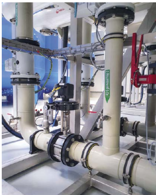
Gleitschieberventile mit einem Nenndurchmesser von 150 mm regeln den Druck am Auslass der insgesamt 12 Umkehrosmose-Einheiten. Auffällig: die kompakten Abmessungen von Ventil und elektropneumatischem Antrieb.
