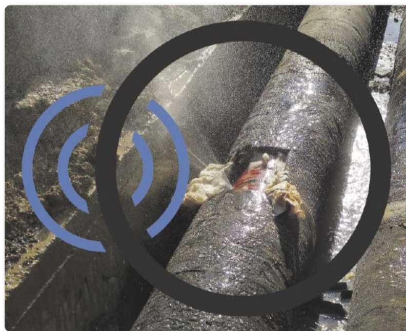
Leckagen, z. B. in Fernwärmenetzen, werden oft spät erkannt und sind aufwändig zu lokalisieren.
