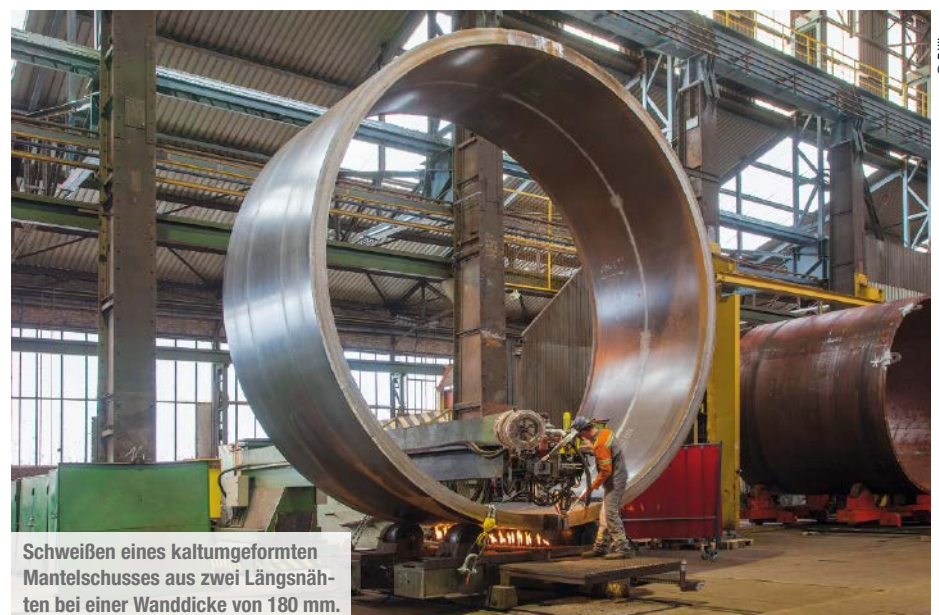
8.600 t Biegemaschine zur Umformung der Mantelschüsse für den Fischer-Tropsch-Reaktor der GTL-Produktionsanlage Pearl in Katar.
