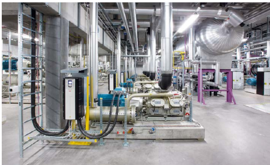
Frequenzumrichter können den Betrieb von Motoren durch gezielte Regelung optimieren.
