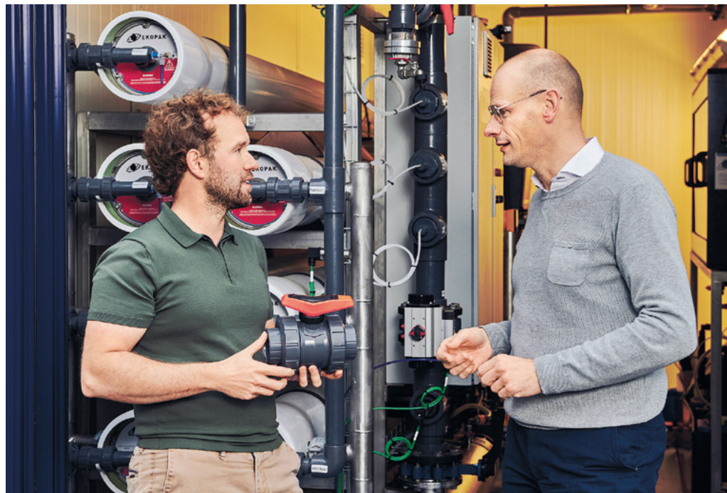
Eine Partnerschaft für automatisierte Prozesse – GF Piping Systems unterstützt Ekopak dabei, Wasseraufbereitungsanlagen kontinuierlich zu optimieren.
