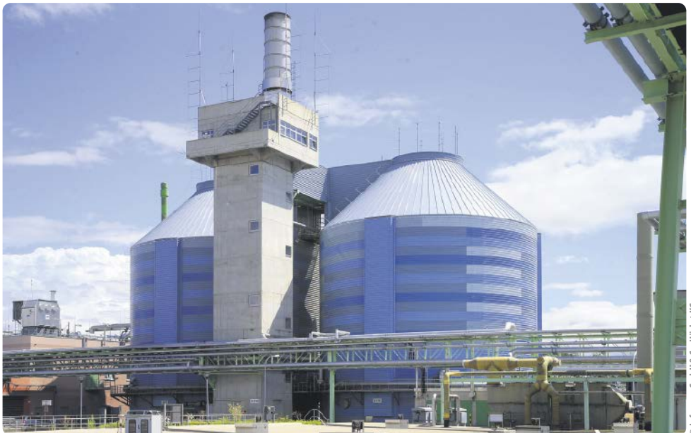
Infraserv Höchst betreibt eine der größten Biogasanlagen Deutschlands.
