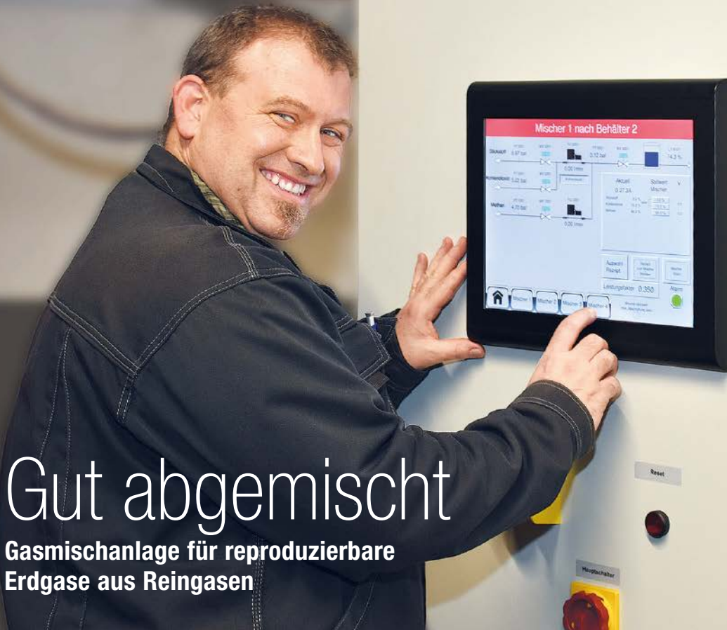
Martin Brüggemann vom GWI probiert die Rezeptsteuerung der einzelnen Gasmischstränge per Touchscreen aus.
