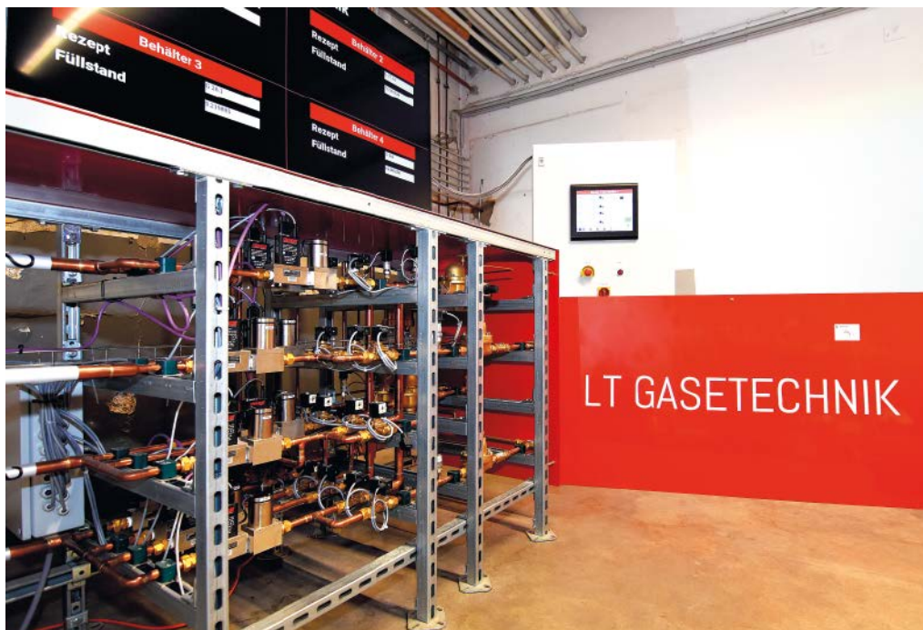
Blick in die Anlage mit Druckreglern, Armaturen und Massendurchflussreglern. Im Hintergrund die Bedieneinheit zur Anlagensteuerung.
