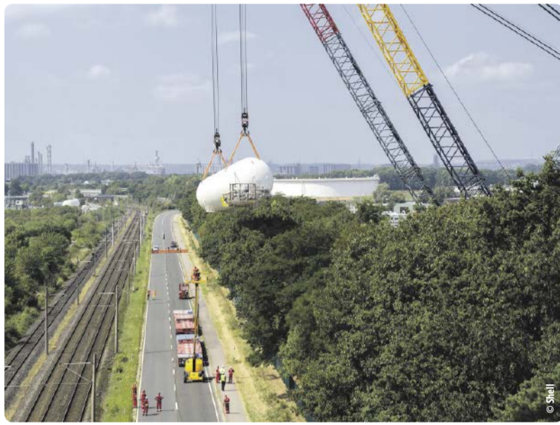
Sichtbares Symbol der Energiewende: Shell hebt drei Bio-LNG-Tanks in den Energy and Chemicals Park Rheinland
