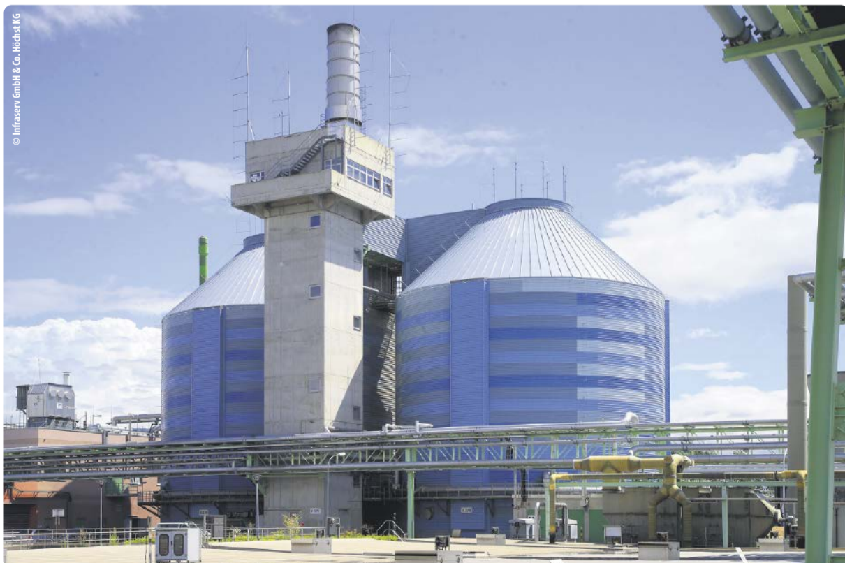
InfraserV Höchst betreibt eine der größten Biogasanlagen Deutschlands.
