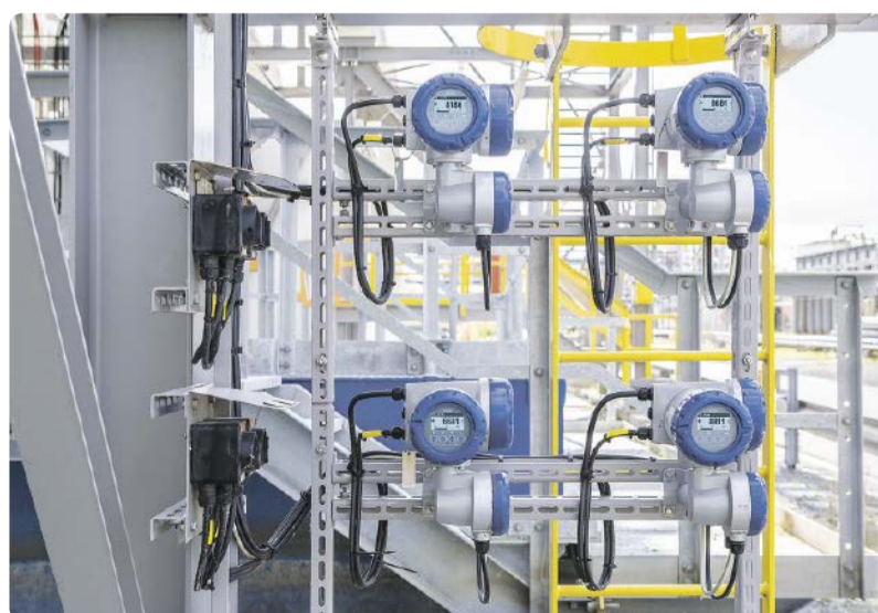
Typische Anwendung von Durchflussmesstechnik in der Chemie: abgesetzte Messumformer mit HART-Schnittstelle
