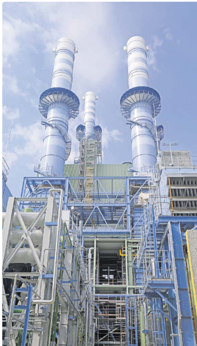
InfraserV Höchst investiert einen dreistelligen Millionenbetrag in Gasturbinenanlagen.
