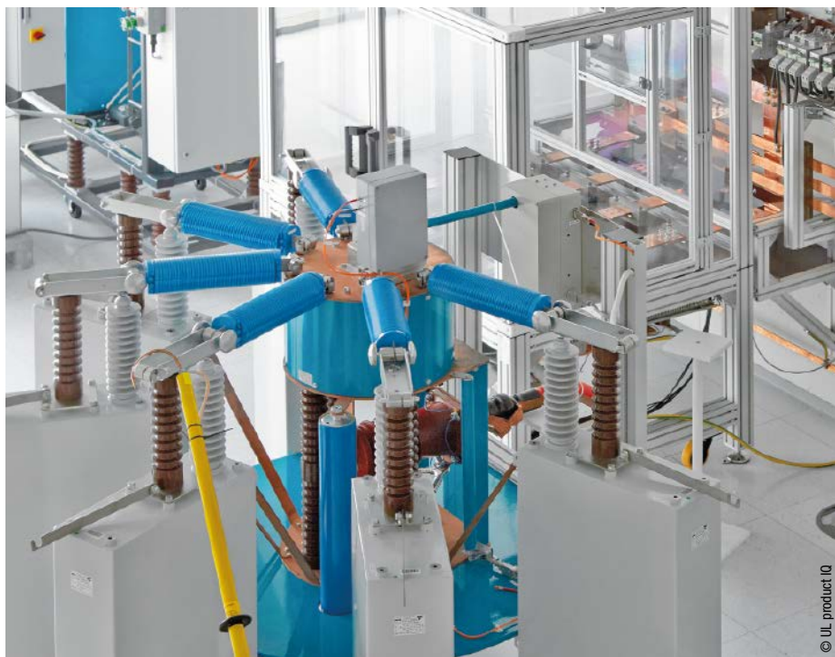
Im Hochspannungslabor werden Komponenten und Geräte der Hersteller geprüft
