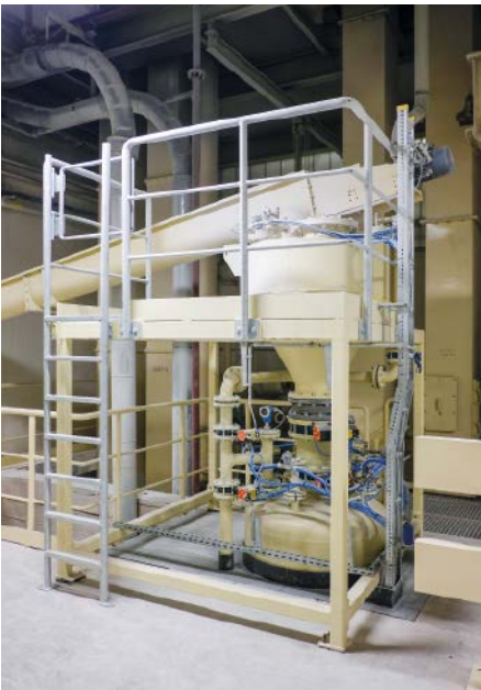
ISS Schüttguttechnik hat die neue Stuckgipsversorgung gemeinsam mit Knauf Engineering geplant und realisiert.
