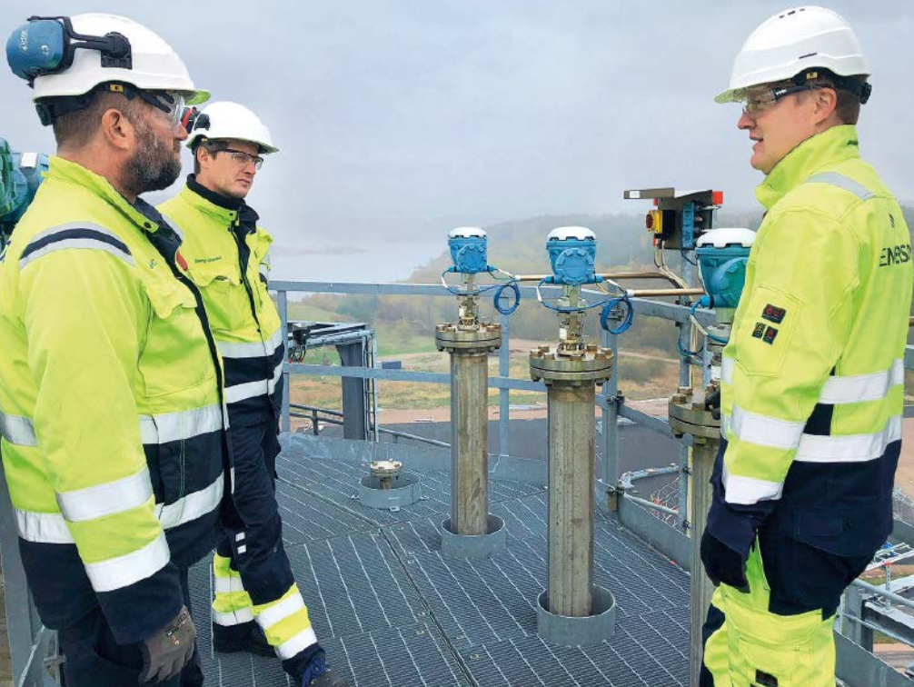
Drei Radar-Füllstandsmessgeräte gewährleisten den zuverlässigen und sicheren Betrieb im Gasum LNG-Terminal in Lysekil, Schweden.
