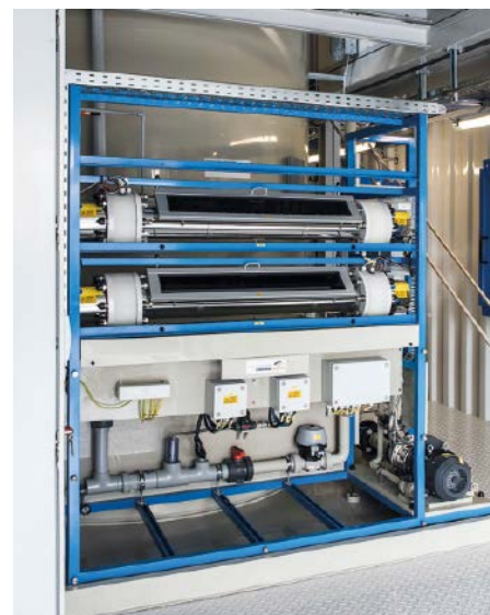
Entfernung der Pharmawirkstoffe (API) mittels UV und Wasserstoffperoxid.
