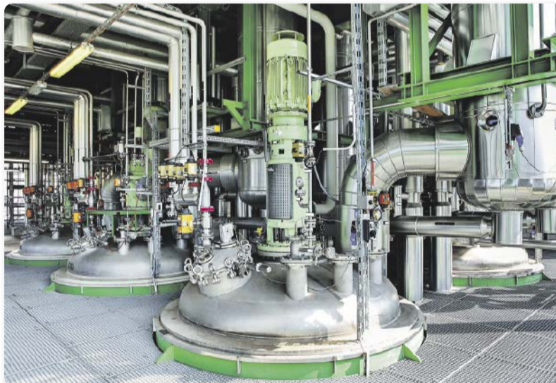
Produktionswerk zur Herstellung der Vorstufe eines Pflanzenschutzmittels. In den Tanks befinden sich Rührwerke zum Durchmischen mehrerer Einzelprodukte. Die Vegapuls-Füllstandsensoren messen mit 80 GHz berührungslos zum Medium und dank ihres schmalen Abstrahlwinkels problemlos an den Rührwerken in den Tanks vorbei.
