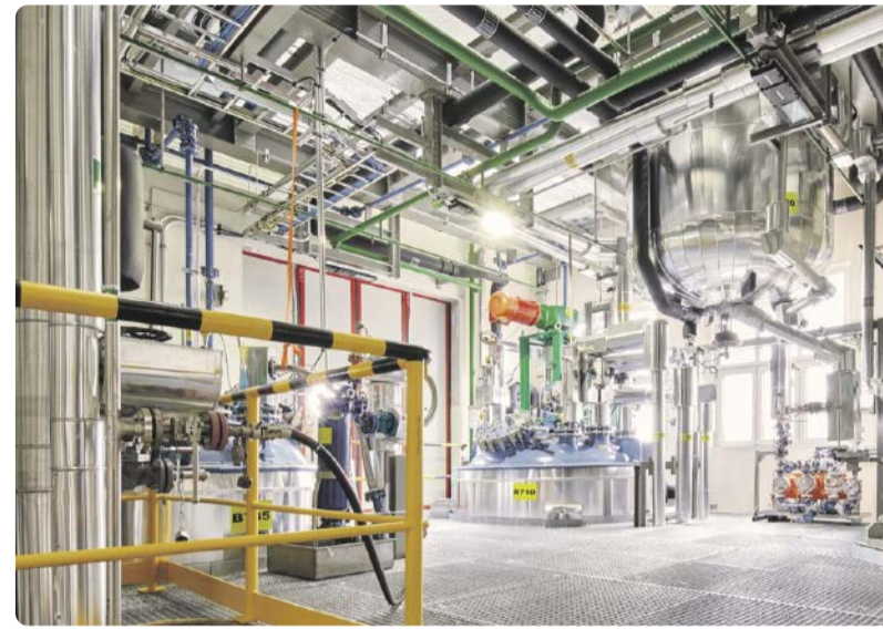
Nach CI-Aspekten und CI-Design errichtete Produktionsanlage bei ESIM Chemicals.
