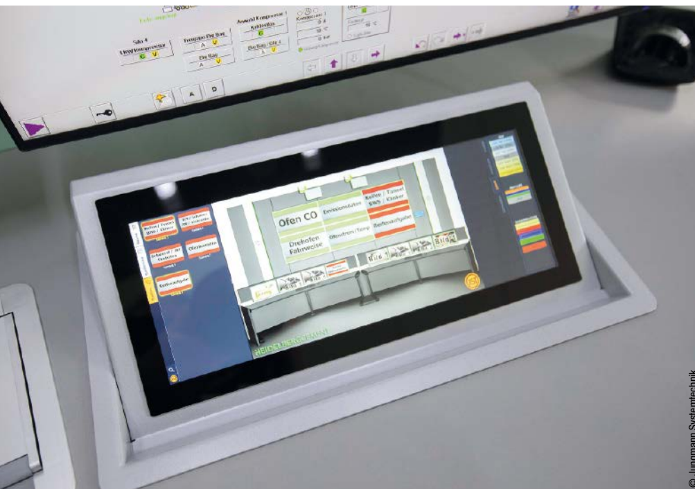
Auf dem Command-Pad, einem im Kontrollraumpult integrierten Touchdisplay, ist die MyGUI aufgeschaltet. Auf dieser interaktiven 3D-Oberfläche sind die Monitore der Arbeitsplätze und die Großbildwand als „Kontrollraumbild“ dargestellt. Links an der Seite sind alle benötigten Quellen abgebildet und können über ihre individualisierbaren Icons einfach auf die Multikonsole oder die Display-Wall gezogen und bedient werden.
