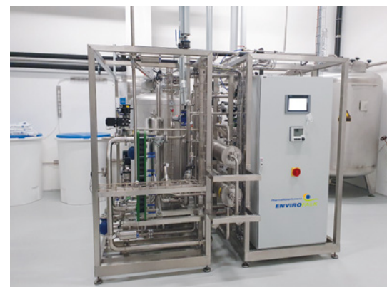
Abb. 1: Erzeugeranlage für Purified Water – thermisch sanitisierbar plus Weichwassererzeugung
