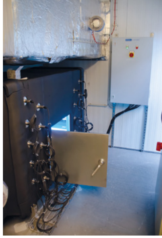
▲ Abb. 4: Vier Lüftungsanlagen von Berger Schinken sind mit TR-Systemen von Sterilsystems ausgestattet
