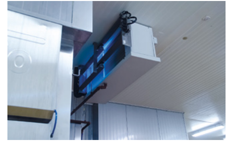
▲ Abb. 1: Um eine rundum hygienische Produktionsatmosphäre sicherzustellen, setzt Berger Schinken UV-C-Entkeimungssysteme von Sterilsystems zur Luftreinigung ein.
