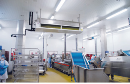
▲ Abb. 3: Um eine rundum hygienische Produktionsatmosphäre sicherzustellen, setzt Berger Schinken UV-C-Entkeimungssysteme von Sterilsystems zur Luftreinigung ein.
