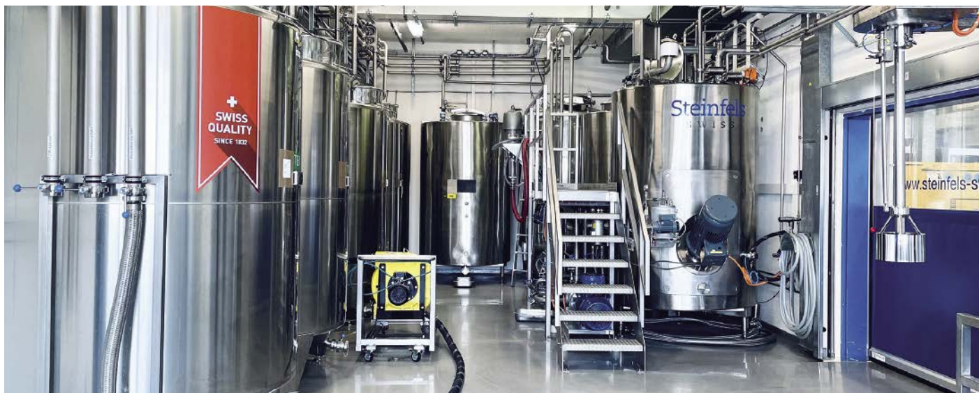
Die neue Pumpe kommt im ATEX- Produktionsbereich im Werk der Steinfels Swiss in Winterthur zum Einsatz.
