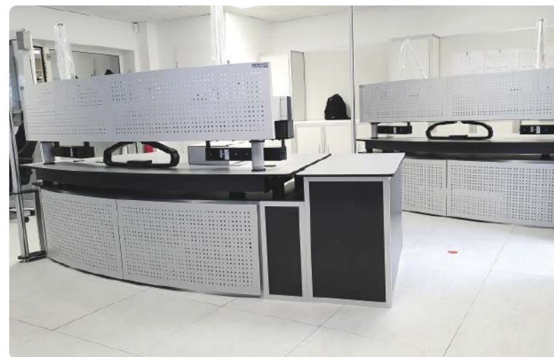
Die neuen Leitstellentelefone erfüllen alle Anforderungen für die Integration der erforderlichen technischen Elemente.
