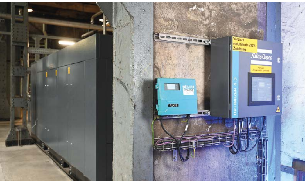
Als übergeordnete Steuerung hilft der neue Optimizer 4.0 von Atlas Copco dabei, die drei Turbokompressoren in jedem Lastpunkt effizient zu betreiben. Außerdem bietet er vor Ort eine gute Anlagenübersicht und sammelt die Warn- und Störmeldungen der drei Kompressoren und der drei Trockner.
