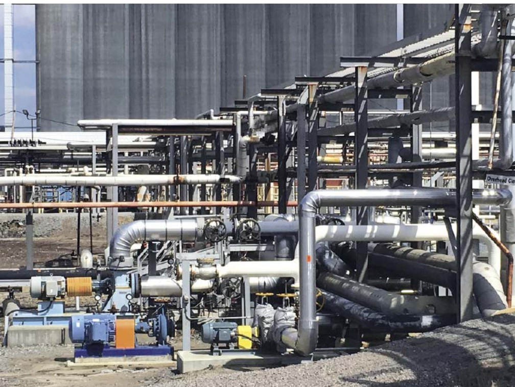
Abb. 1: Um den Seeverkehr am Laufen zu halten, stehen weltweit an wichtigen Häfen Tanklager: Die Anlagen bestehen aus einer großen Zahl von Tanks, in denen auch Treibstoffe gelagert werden.
