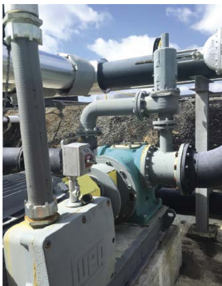
Abb. 2: Die Schraubenspindelpumpe sorgt im Ölterminal für Effizienz und Zuverlässigkeit.
