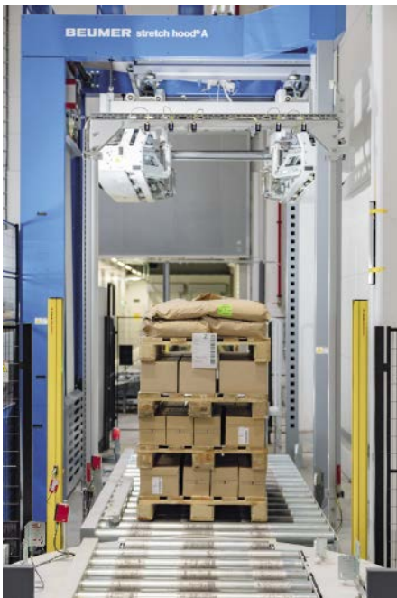
Abb. 2: Über Rollenbahnen können die palettierten Waren der Verpackungsanlage zugeführt werden.
