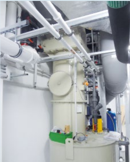
Abb. 1: Die Reinigung der schadstoffbehafteten Prozessabluft aus den Laborprozessen erfolgt in einem vertikalen Abluftwäscher Airtop KS-V mit Tropfenabscheider Zyklotop der Firma Richard Tscherwitschke.
