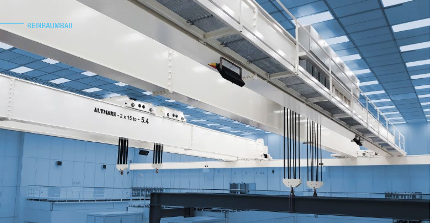
Gesamtansicht der Krananlage
