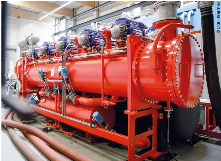
Abb.: Die Quantum-Power-Kältemaschinen von Engie Refrigeration garantieren für einen deutschen Chemiekonzern höchste Versorgungssicherheit am Standort Singapur.
