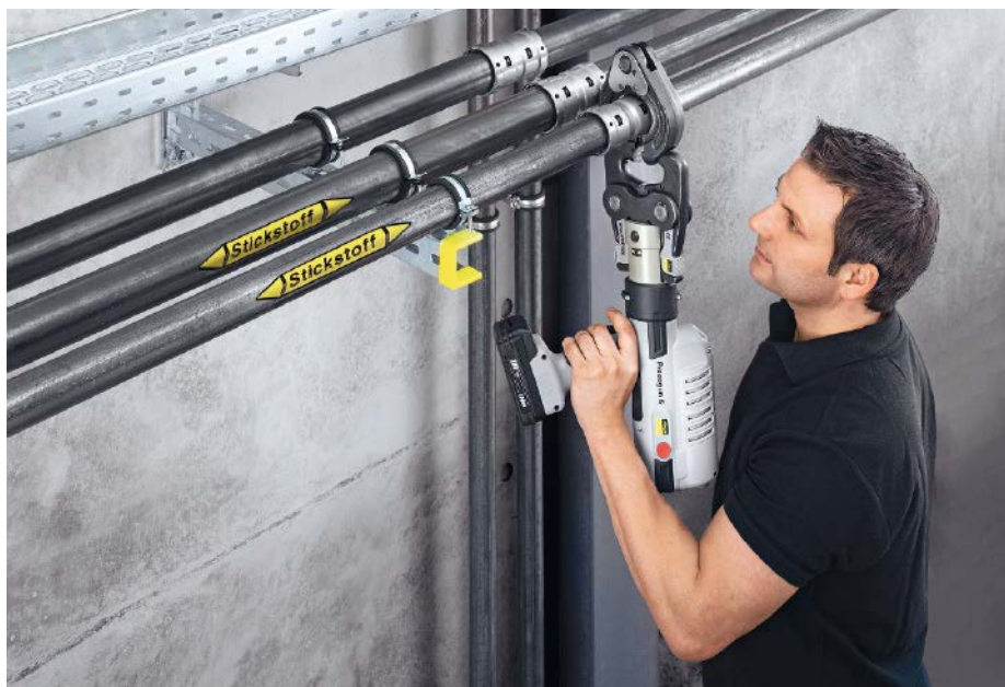
Abb. 2: Die „kalte“ Pressverbindungstechnik sorgt bei Anlagenneuinstallationen und -erweiterungen für wesentlich geringeren Aufwand. Das reduziert die Stillstandzeiten von Maschinen und Anlagen.
