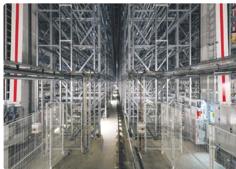
Für einen wirtschaftlichen Betrieb des Logistikzentrums kommen zahlreiche Automatisierungslösungen zum Einsatz.
