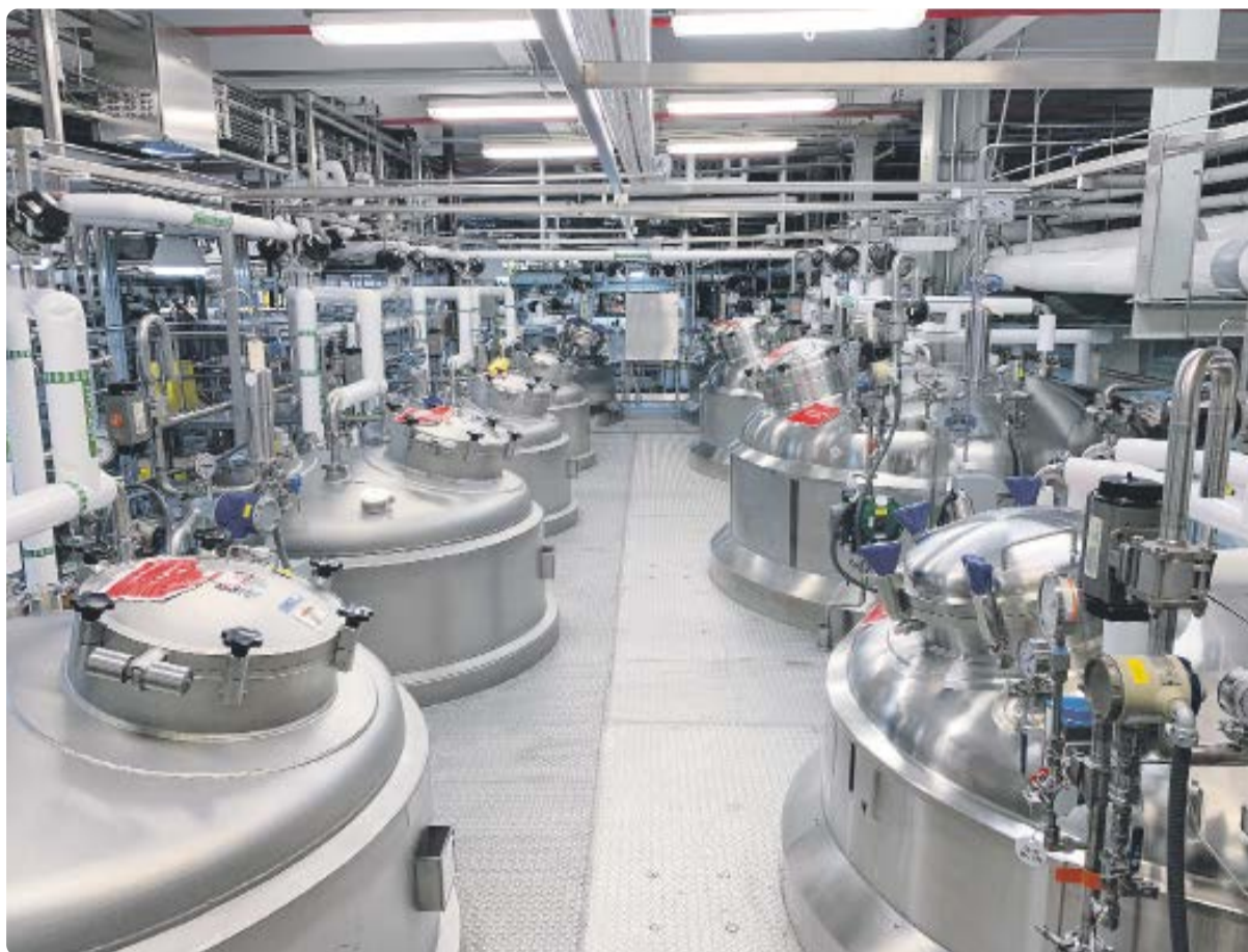
DPR Construction musste Herausforderungen am Standort bewältigen, als neue und bestehende Anlagen, darunter zusätzliche Filtrationsanlagen und größere Materialbehälter, unter beengten Platzverhältnissen eingebaut werden mussten.
