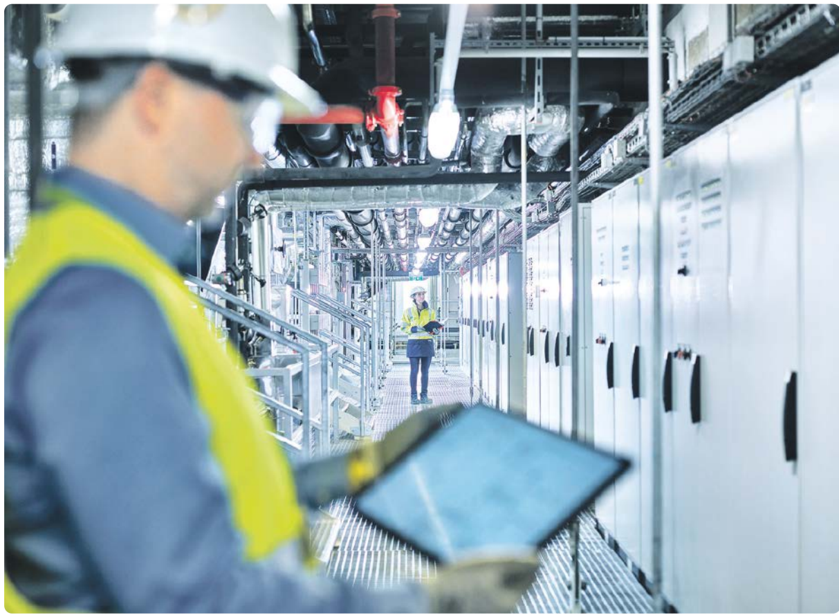
Das laufende Tagesgeschäft eines produzierenden Betriebs stellt bei der Umsetzung von Veränderungen eine Herausforderung dar. Noch viel mehr hängt das Gelingen jedoch von den Menschen ab, die für den laufenden Betrieb sorgen. Eine gut durchdachte und konsistente Kommunikation, die auf die unterschiedlichen Bedürfnisse einzelner Gruppen Rücksicht nimmt, kann erfolgsentscheidend sein.
