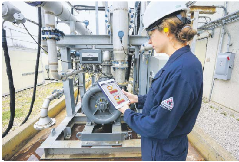
Bei der Durchführung einer routenbasierten Vibrationsüberwachung von Geräten können Außendiensttechniker das in das Handheld-Gerät eingebettete Fachwissen nutzen und durch zusätzliche Analysen geführt werden.
