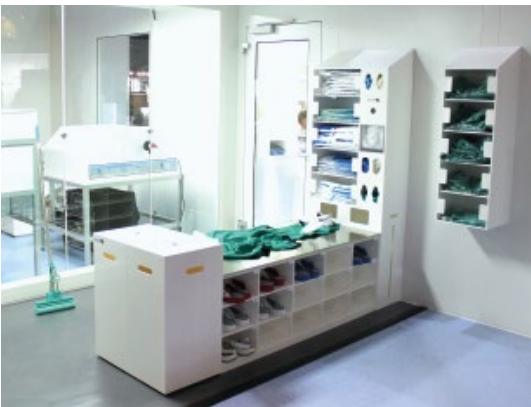
Abb. 3: Der Zugang zum eigentlichen Reinraumteil erfolgt über eine Schleuse in den Bereich der höchsten Reinheitsklasse.
