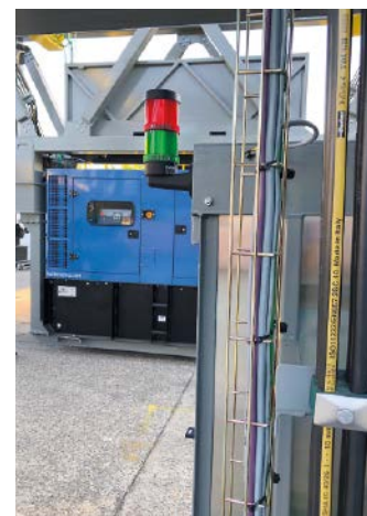
Abb. 3: An jedem Schaltschrank ist eine aufmerksamkeitsstarke Signalsäule KombiSIGN angebracht. Diese zeigt an, wann die Maschine fahrbereit ist. Die rote Lampe leuchtet, wenn ein Parameter nicht in Ordnung ist und Maßnahmen ergriffen werden müssen.
