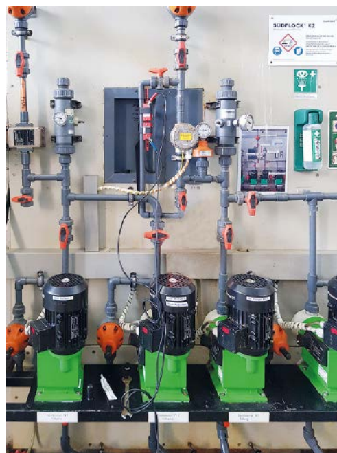
Abb. 3: Die Fällmittelzuführung mit Pumpsystemen und der Clamp-On deltawave-Durchflussmesseinrichtung
