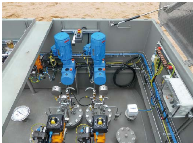
Abb. 3: Mit der Variante einer komplett verschweißten Pendelleitung blieb die hydraulische Verbindung zwischen Pumpenkopf und Treibkopf absolut dicht, sodass ein zuverlässiger Antrieb des Pumpenkopfs im Tank sichergestellt war.
